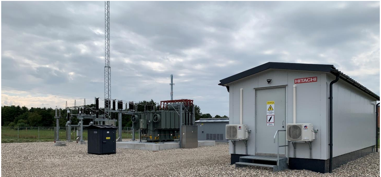
Figur 8: Eksempel på transformerstation i eksisterende anlæg. Installationens størrelse vil være afhængig af anlæggets kapacitet
